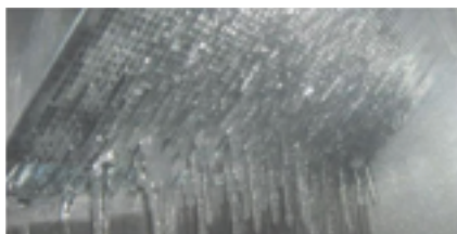
Rys. 7. Zamrożone kanałki rekuperatora krzyżowego [15]
